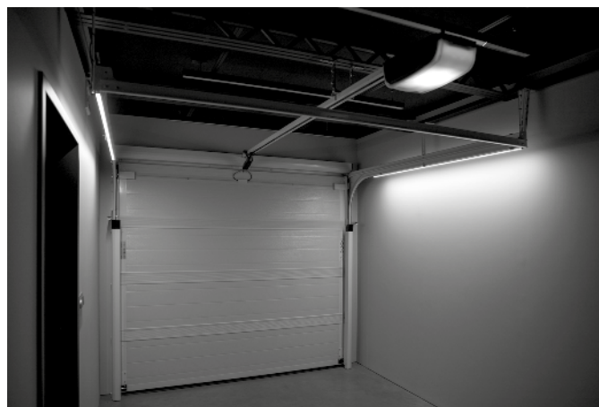
Rys. 15. Oświetlenie LED pod prowadnice.
